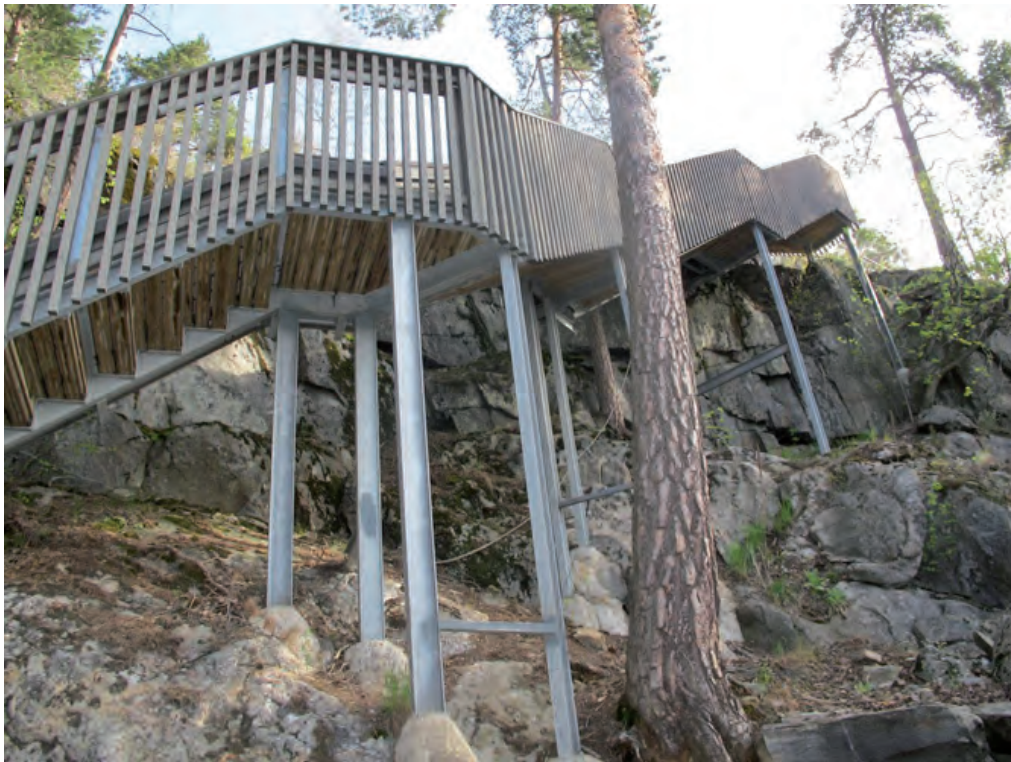
Hirsisaunalle johtava porras on jyrkkä ja korkea. Se on tuettu kallioon teräsrakentein. sauna vesijohdot ja viemäri on sijoitettu portaan kaidekoteloon.
